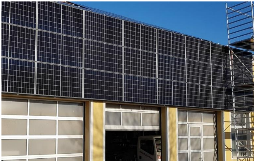
Beispiel Fassade Feuerwache mit PV-Fassadenmodulen
