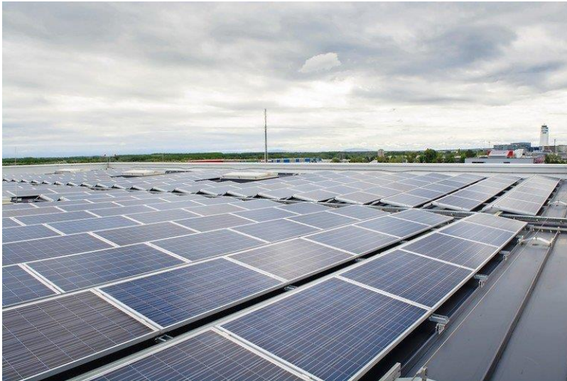
Beispiel PV-Süd Anlage
